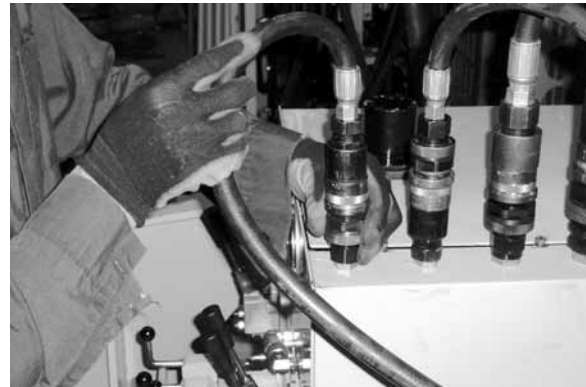
Conexiones hidráulicas de la GBM
