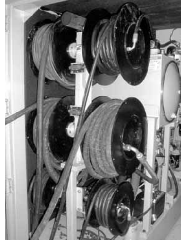
Mangueras hidráulicas de la fuente de poder
