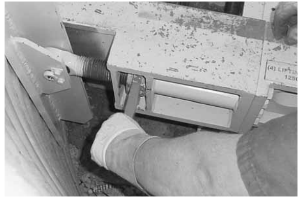
Tensor del pozo
