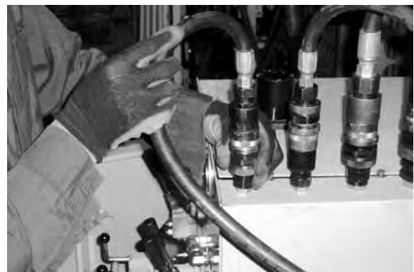
Conexões hidráulicas da GBM
