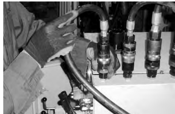
Conexões hidráulicas da GBM
