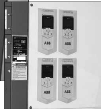
ABB ACS880 VFDs
