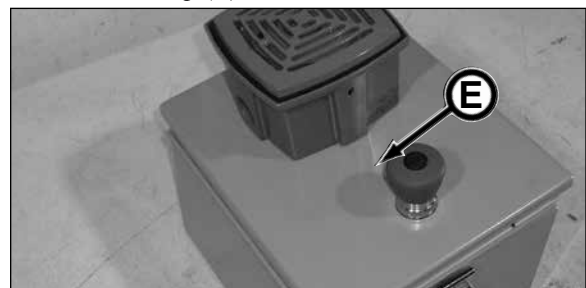
E-Stop (D) on Pit Box
