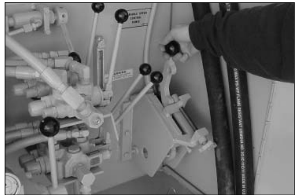
Unidad de bombeo 5000 - Cable de control de carrera
